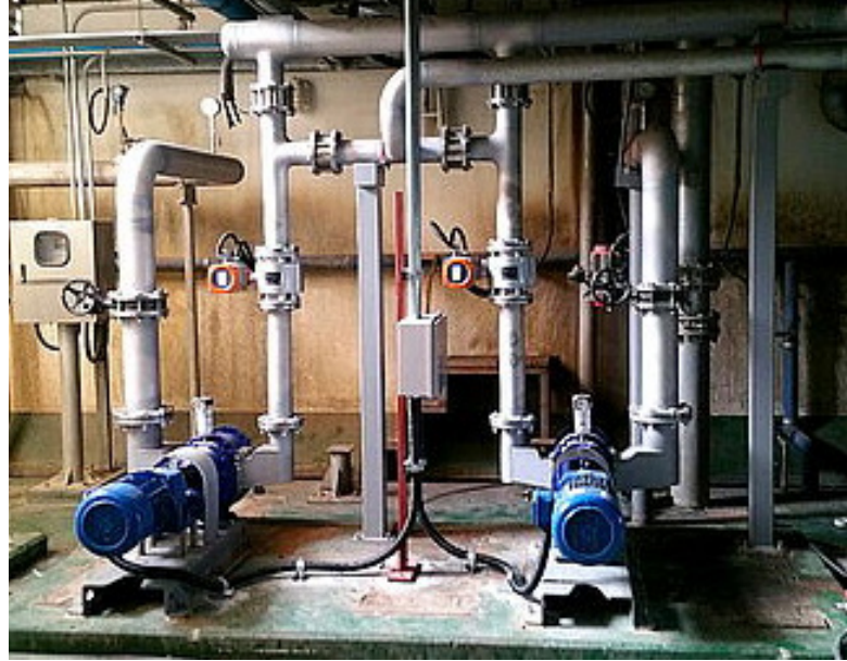
MBR filtratie met draaizuigerpomp: slechts één pomp, minder leidingen en kleppen
