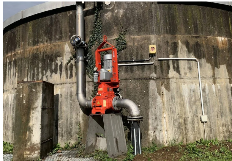
XRipper XRP136-140Q installato nel depuratore
