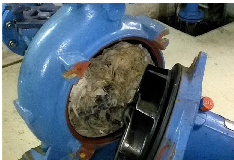
Bomba entupida sem XRipper
