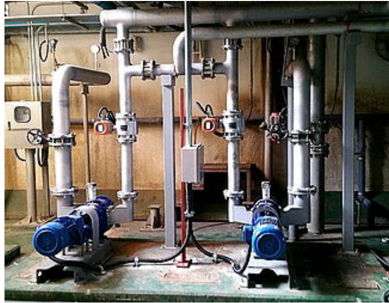
Filtración MBR con bomba lobular rotativa: sólo una bomba, menos tuberías y válvulas
