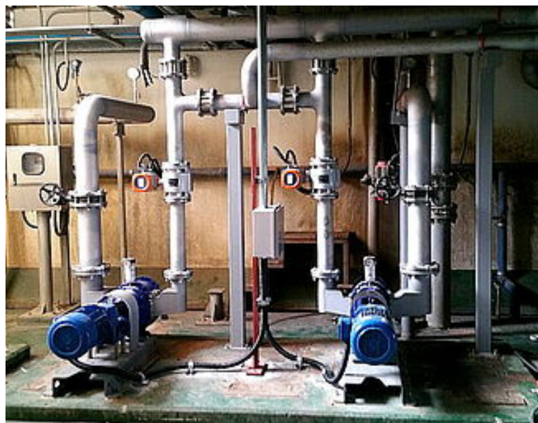
Filtração MBR com bomba de lóbulo rotativo: apenas uma bomba, menos tubulações e válvulas
