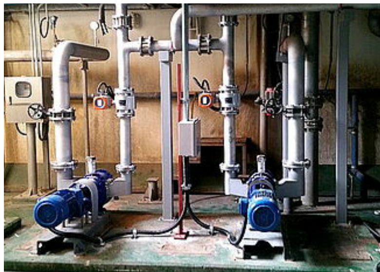
Filtrazione MBR con le pompe a lobi rotativi Vogelsang: una sola pompa, meno tubazioni e valvole
