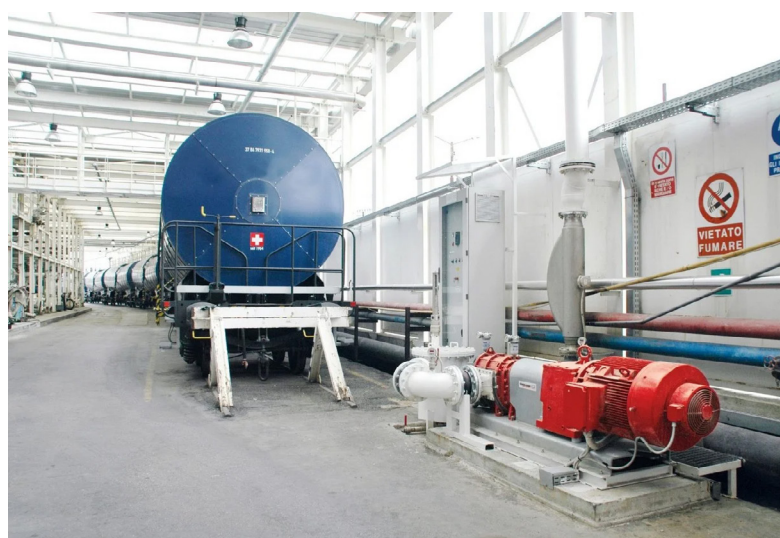
Depósito de Getoil en Génova
