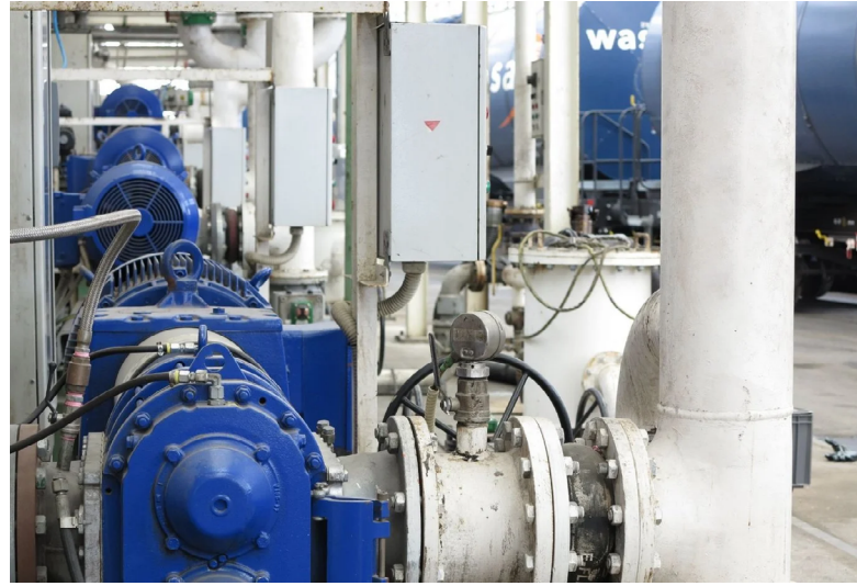
Vogelsang rotationspumpe VX186 installeret på Getoils depot i Genova
