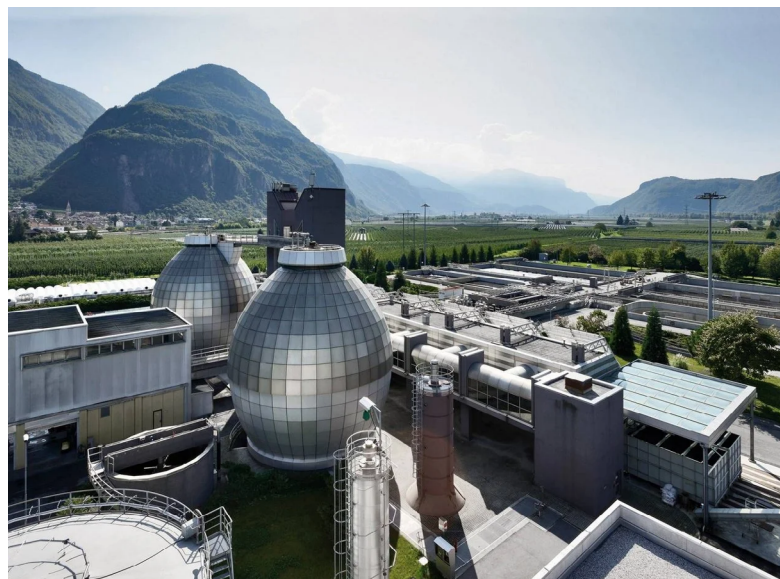
Renselanlæg med kapacitet på 342.000 PE, der behandler kommunalt og industrielt spildevand i ATO 2-området
