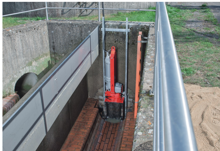
Testinstallation, der reducerer vådservietter og fremmedlegemer og sikrer stabil spildevandstransport til rensesanlægget
