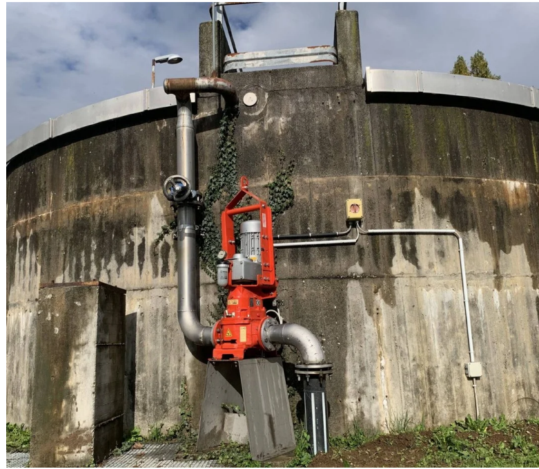
Doppelakslet neddeler installeret før slamfortykkelsen for at sikre stabil drift og reducere vedligeholdelsesomkostninger
