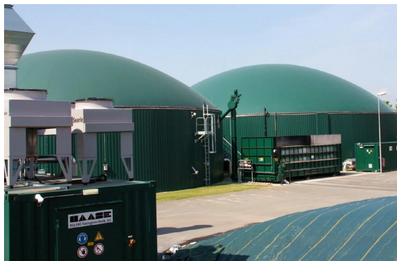
Planta de biogás de Bioenergie BAGUS GmbH & Co. KG
